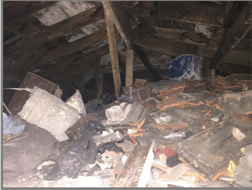
Yıkılan Çatı katından kalan tuğla ,kiremit ve moloz..
